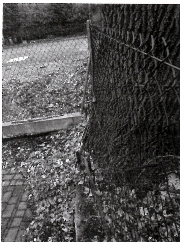
Kolizja z ogrodzeniem
